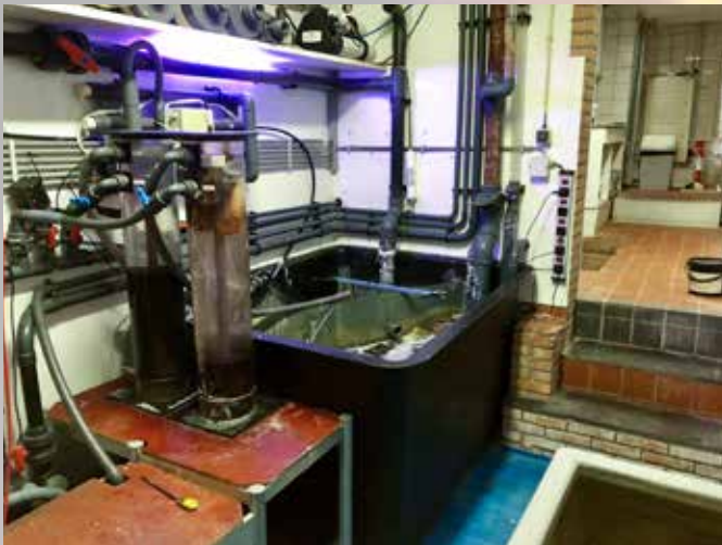
De technische ruimte
