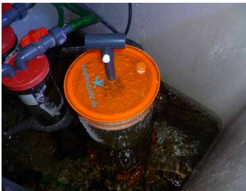
Zeoliet-filter in werking in het refugium van Urbain Appeltans
